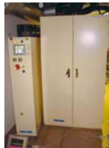
節水型除害裝置
