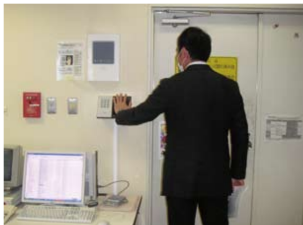
図3 サーバ室の入退室管理システム
