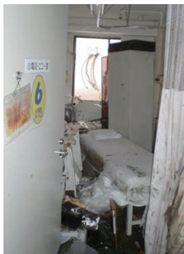
1階は浸水しがれきやヘドロで壊滅状態になりました（病院提供）。
