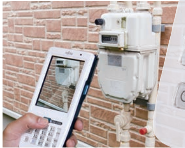
保守点検の機器確認に
