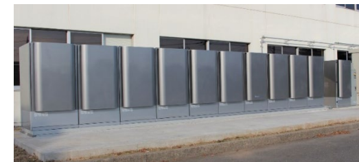
Fuel cell power generators (Kumagaya SSC)
