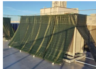
室外機の日除け (本社・東京工場)
