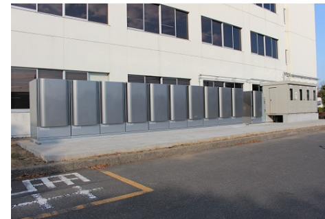
燃料電池発電システム（熊谷SSC）
