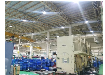
水銀灯から交換したLED照明（FDTP）
