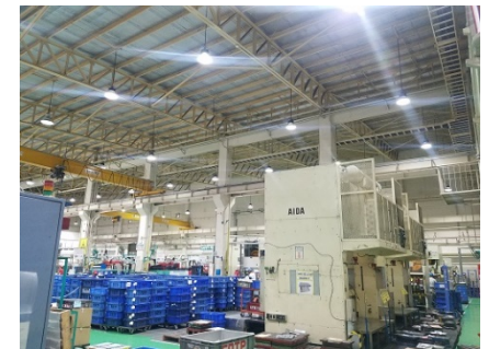
水銀灯から交換したLED照明（FDTP）
