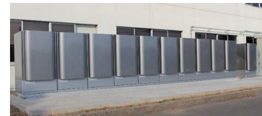
燃料電池発電システム（熊谷SSC）
