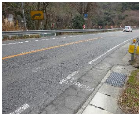
修繕前 ひび割れ率40%以上
