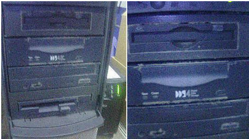
【写真9】サーバ前面の隙間にホコリが付着している。（DAT 内蔵の例）
