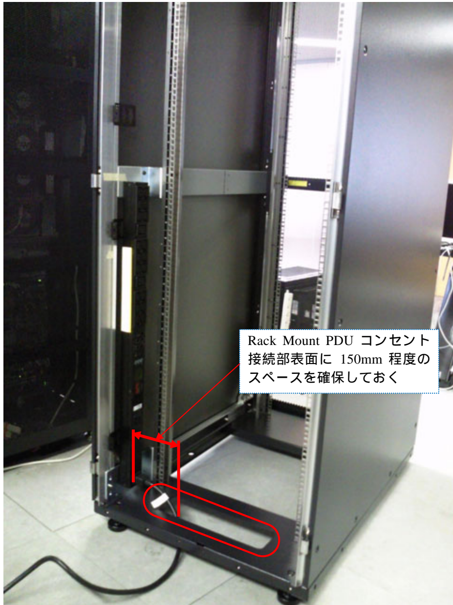
図 24. ラック背面写真
