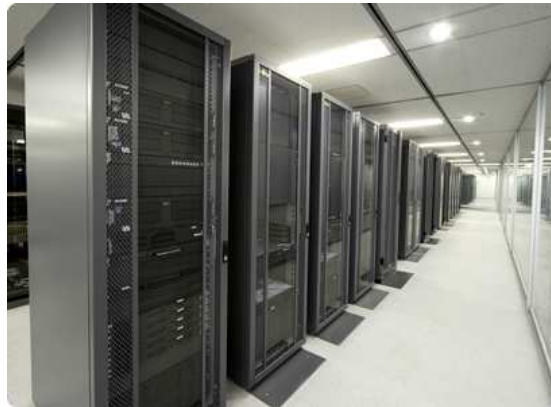
サーバルーム
