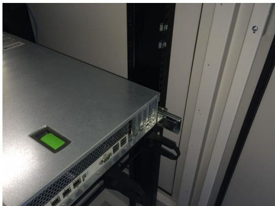
(ウ) PRIMERGY RX2520 M1 搭載後のケーブルリング確認検証
