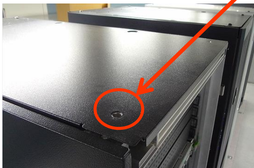
3) ボルトが外れた状態
