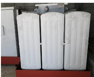
廃却PCB含有機器
