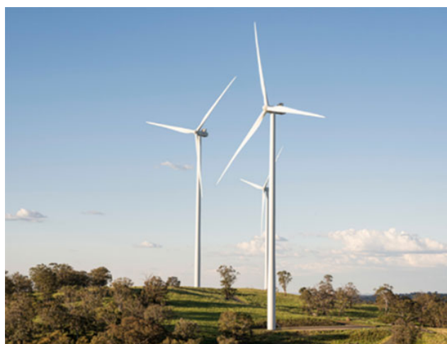
Sapphire Wind Farm CWP Renewables社が運用するニューサウスウェールズ州最大の風力発電所
