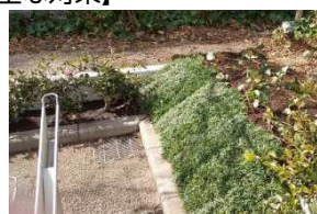
(a) 擁壁+盛土 富士通 SS：敷地周囲を擁壁と止水板で防御
