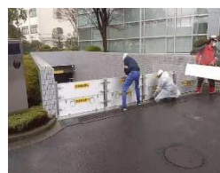
(a) 脱着式止水板 川崎工場：周囲の出入り口を止水板で防御
