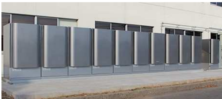
富士通フロンテック 熊谷 SSC に設置された燃料電池発電システム
