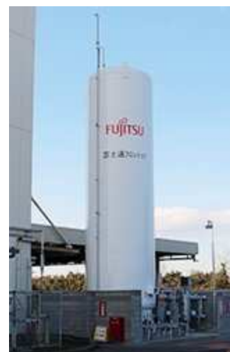
燃料貯蔵用タンク
