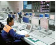
奈良市消防通信指令総合システム
