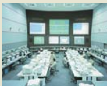
Internet Data Center
