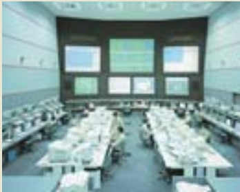
Internet Data Center
