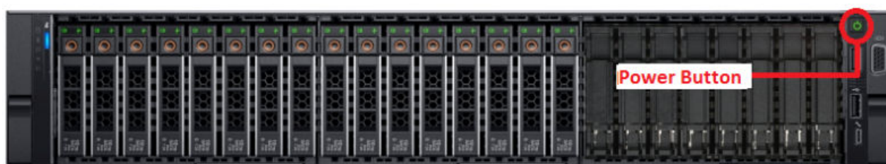
図 2.24 コントローラー部の電源投入
