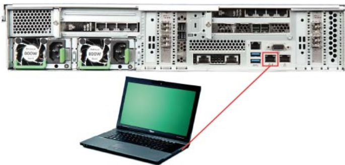
図 3.1 コントローラー部へのノート PC の接続
