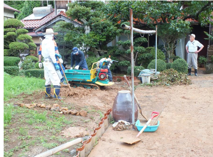
R3・7豪雨災害高齢者宅の土砂撤去
