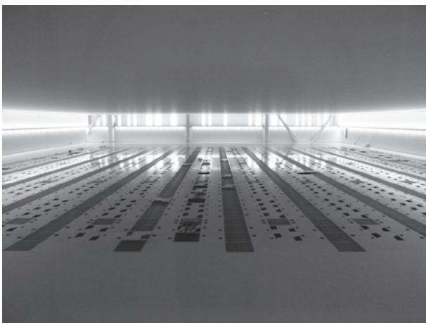
図-1 3階計算機室（「京」搬入前）
