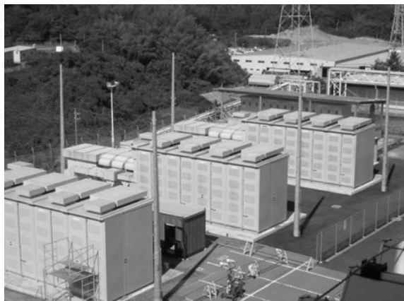
図-3 三重工場のNAS電池施設 Fig.3-NAS battery system in Mie Plant.
