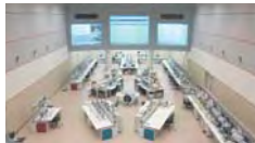
館林システムセンター 統合管制室
