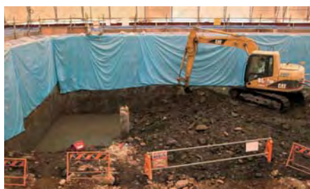
須坂工場における地下保管槽からの汚染土壌掘削状況
