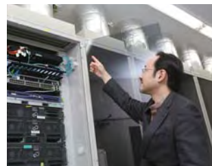
冷気を直接ラック内に供給することでサーバの冷却効率を高める特注ダクト
