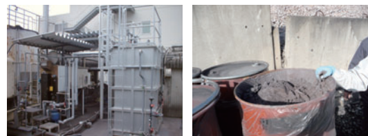
減圧脱水乾燥機(左)、膜濃縮設備(右) シリコン汚泥
