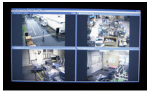
監視カメラシステム
