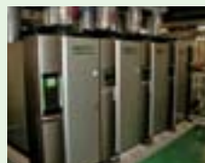
新井工場 ボイラー設備
