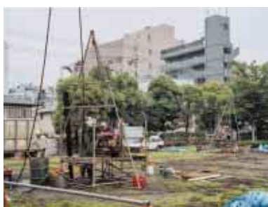
浄化設備（富士通川崎工場）
