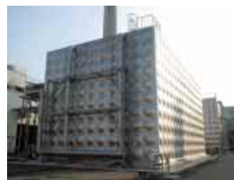
水蓄熱槽(富士通三重工場)
