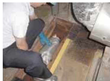
排水溝上部に土のうを設置し、下水への流入を防止する(富士通宮城エレクトロニクス)
