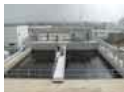
銅めっき廃液処理設備
