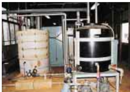
浄化設備(川崎工場)
