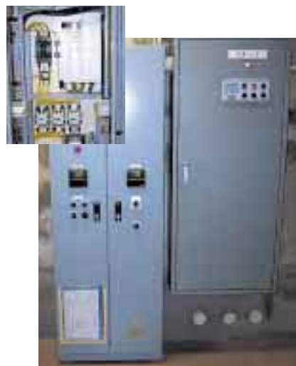
インバータ制御盤(沼津工場)
