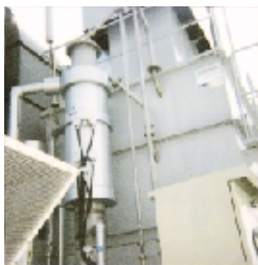
キシレン有機排気処理設備（会津若松工場）
