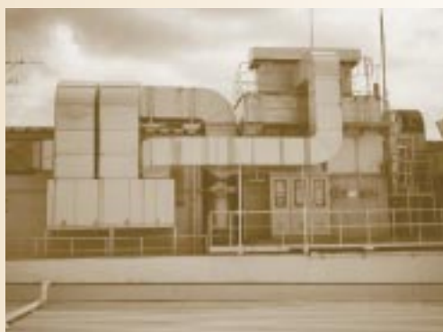
有機排気処理設備(三重工場)
