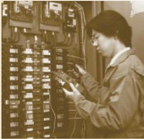
簡易電力モニタによる測定
