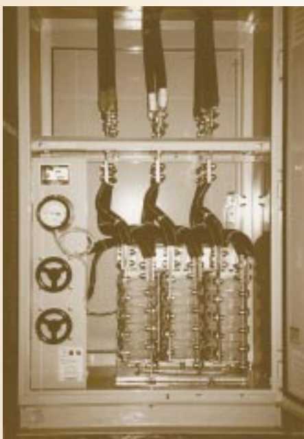
節電器の設置状況(川崎工場)
