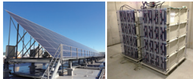
実証実験に用いた太陽光パネルと蓄電池
