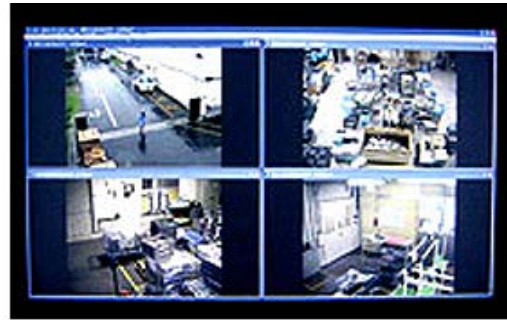
監視カメラシステム
