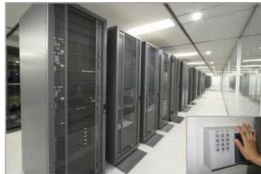
サーバールーム 約300台の最新のサーバ・ストレージ機器を設置し、お客様ICTシステムの検証やデモンストレーションに活用中です。
