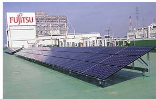
富士通小山工場の太陽光発電パネル
