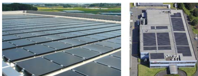
富士通テレコムネットワークス株式会社関城工場の太陽光発電パネル
