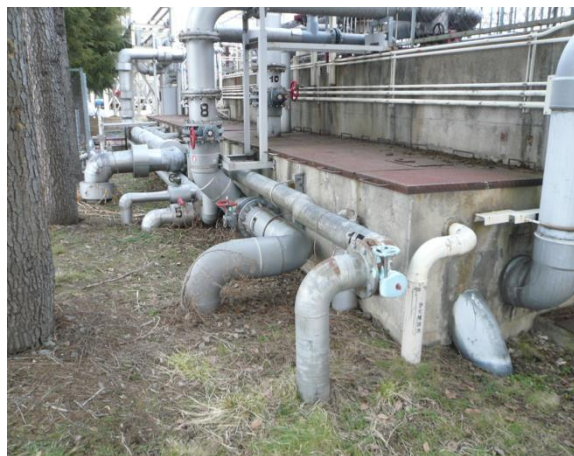
<埋設配管 架空化前>
