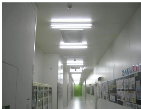
( LED蛍光灯 クリーンルーム内 )
