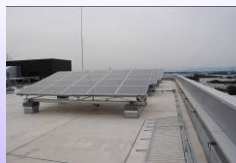
【solar power generator】
